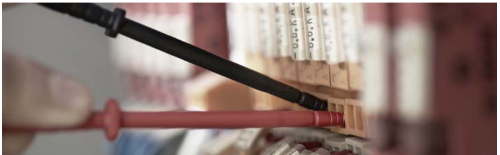
保险丝盒和配电箱的测量
